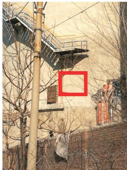
图15 筒仓背部裂缝图
